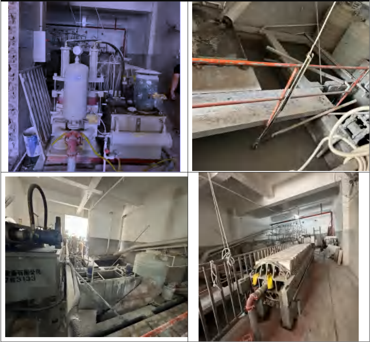
图 3-1 生产废水治理措施现场照片
